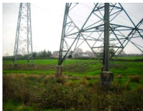
Pylônes sur le terrain
